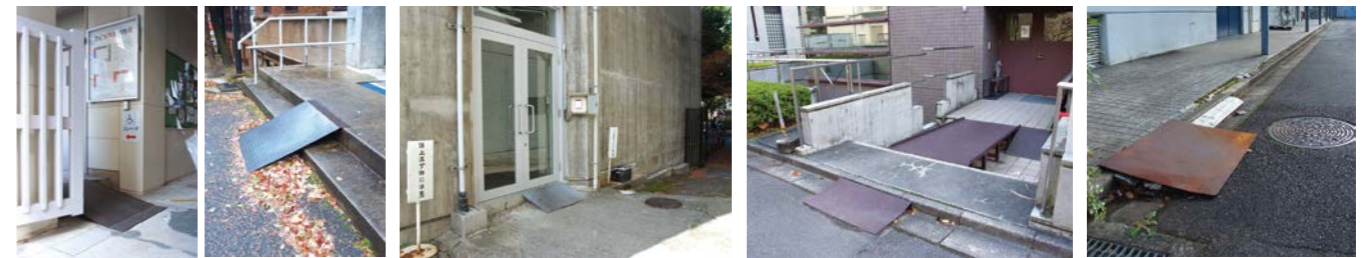
△応急的な仮設スロープで、斜度がきつかったり、不安定になっている事例。 ×時間外通用口だろうか。セキュリティロックが高いところにあり、傾斜もきつく、開き扉なので車椅子では利用できない。 △脱輪した時のリスクを考えると車椅子の使用はためらわれる。 △スロープの一部の凹凸が激しく、登り口にも急な斜度が付いている。
