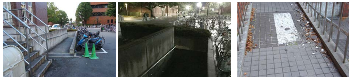
△昼間はよいが、夜間、真っ暗になっている例。コンクリートに囲われていて街灯光が入らず、 健常者でも足元が不安になる 。スロープにかぎらず、 夜間の照明状況のチェック をしたい。 △スロープの タイルが割れている 。
