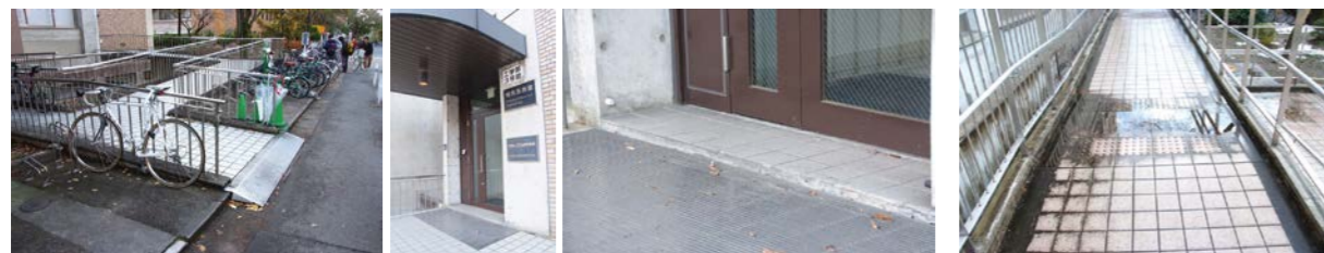
△スロープそのものは問題ないが、 その先の扉で段差がある 事例。 △水がたまり、 滑りやすくなっている 事例。
